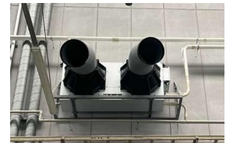
高崎支店 工場エアコン
