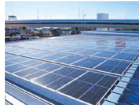
浦和支店 太陽光発電システム
